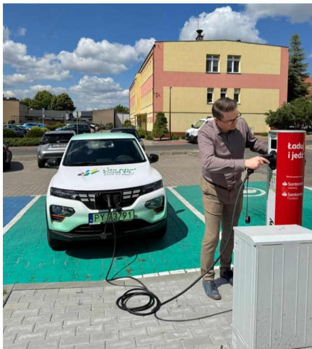
Fotografia 6. Stacja ładowania pojazdów elektrycznych Źródło: profil Facebook Gminy Kleczew
